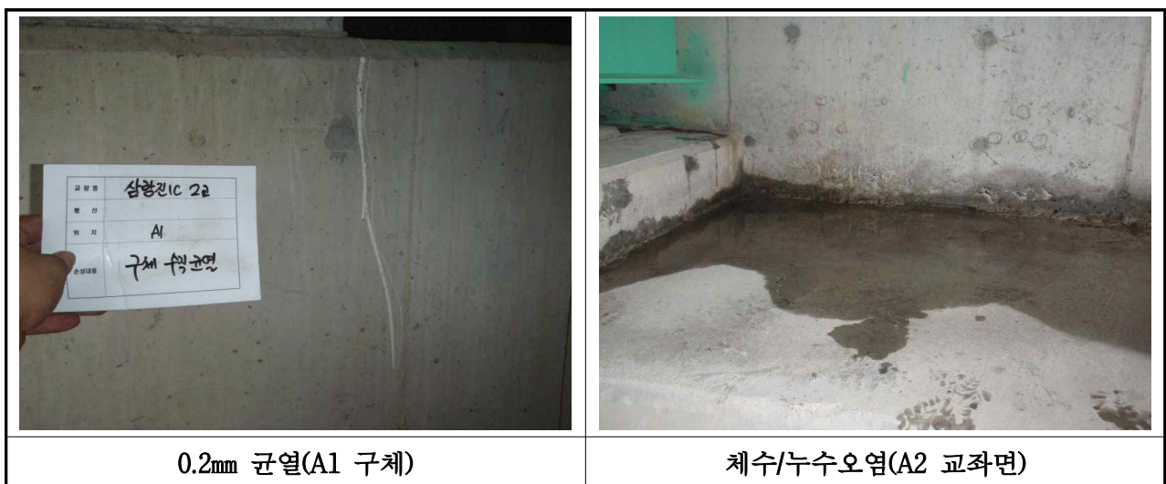
【사진 3.2.8】 교대 손상현황
