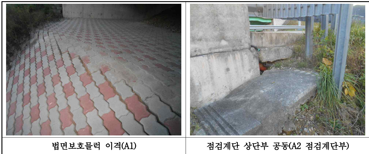
【사진 3.2.8】 교대 손상현황(계속)
