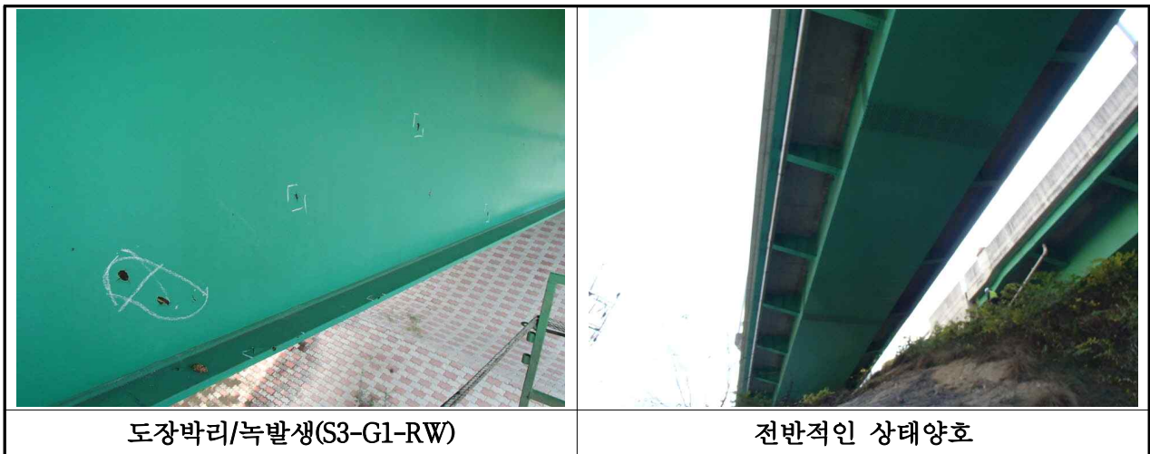
【사진 3.2.5】 강박스 거더 외부 손상현황
