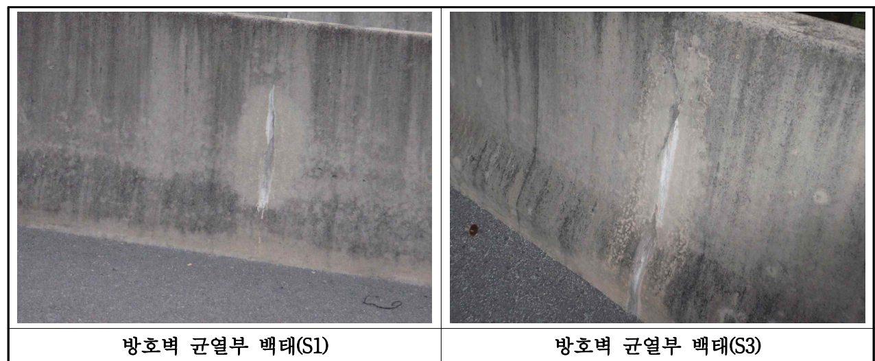
【사진 3.2.20】 방호벽 손상현황
