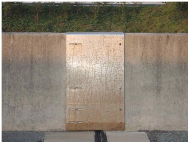
차수판 앵커볼트 탈락
