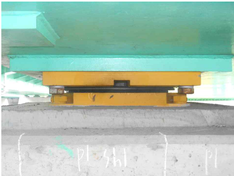
받침장치 전경 (가동단)
