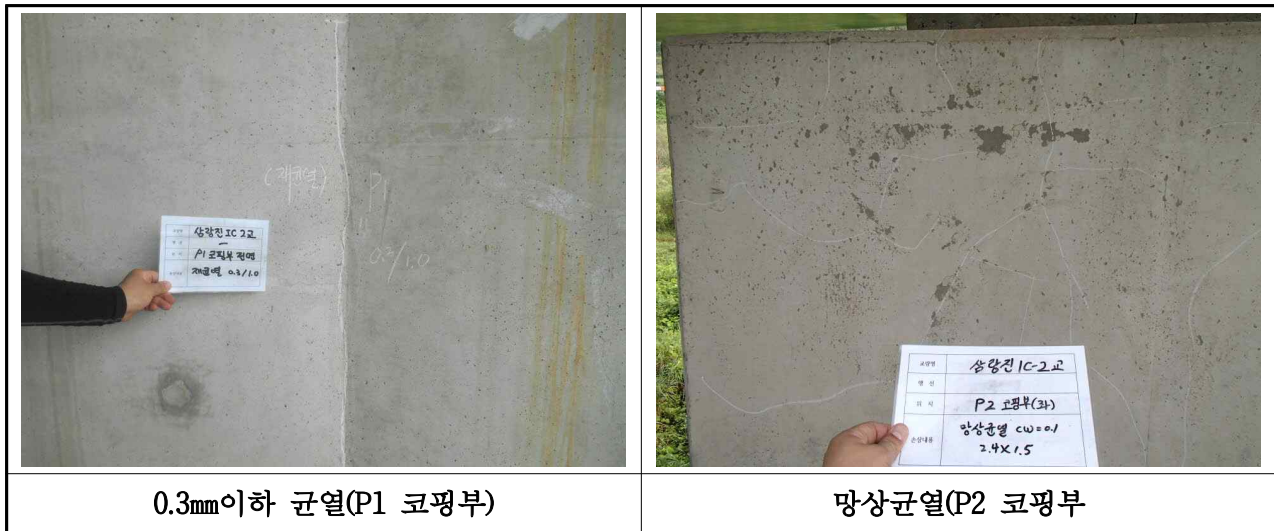
【사진 3.2.10】 교각 손상현황
