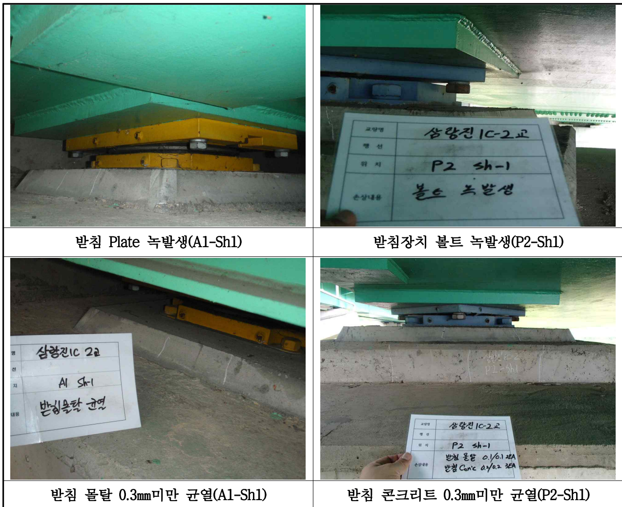
【사진 3.2.12】 교량받침 손상현황
