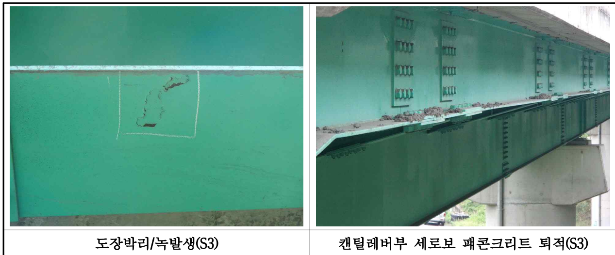
【사진 3.2.6】 가로보 및 세로보 손상현황
